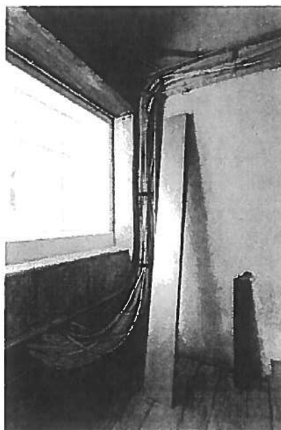
overvolle kabelgoten Eerste Kamer
