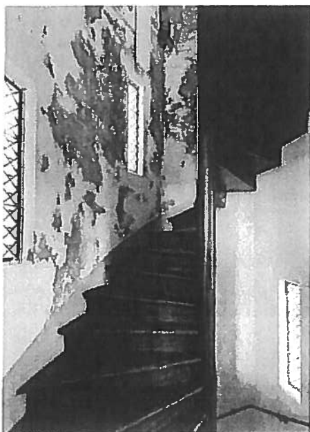
achterstalling onderhoud Mauritstoren Eerste Kamer
