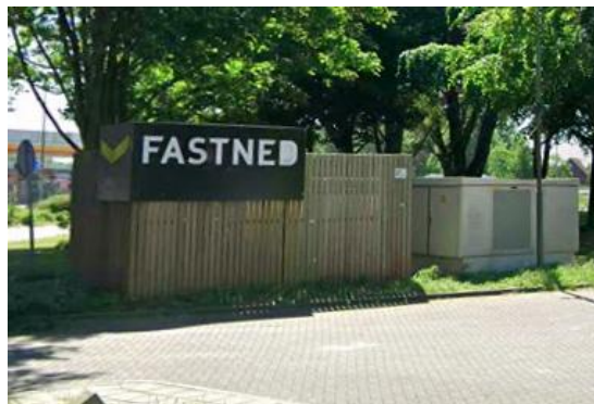
Figuur 11 Transformatorhuisje Sandelingen-Oost
