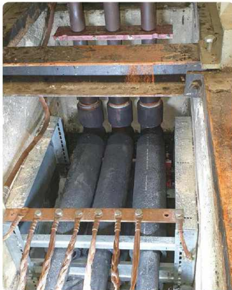
Figuur 14. De elektrisch niet-geïsoleerde kabeleindsluiting (overgang van kabel afkomstig van de transformator buiten, naar railsysteem MS-installatie) in de kelder waar kortsluiting optrad, zoals de monteurs de situatie aantroffen. Het is onbekend of het water nog hoger heeft gestaan (bron: Enexis).
