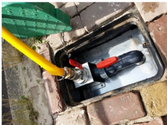
Hier in gebruik; gekoppeld met de storz koppeling. Deze koppeling wordt alleen hier gebruikt. De nieuwe afgiftepunten gebruiken de Camlock koppeling. Camlock 50, male op wal, female aan boord.
