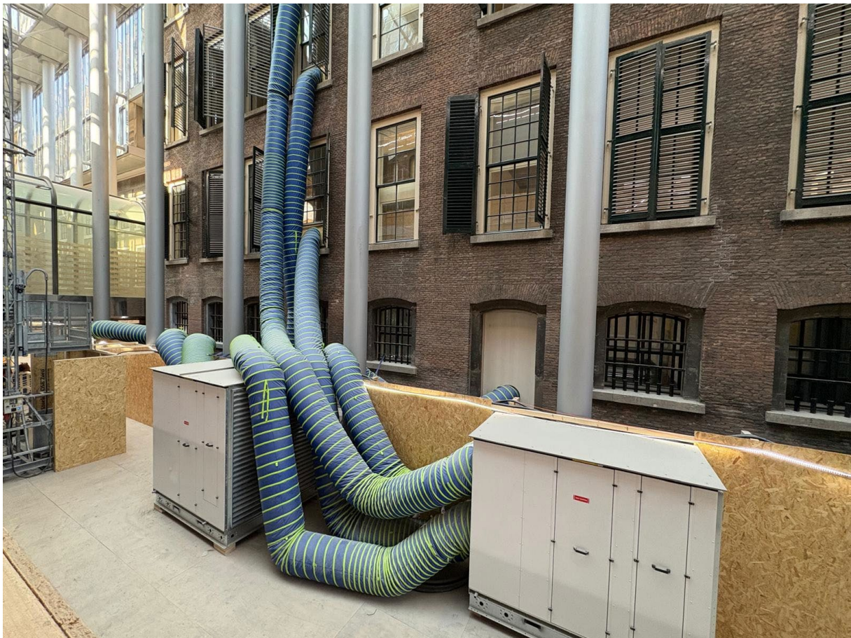
Tijdelijke klimaat installaties Tweede Kamer
