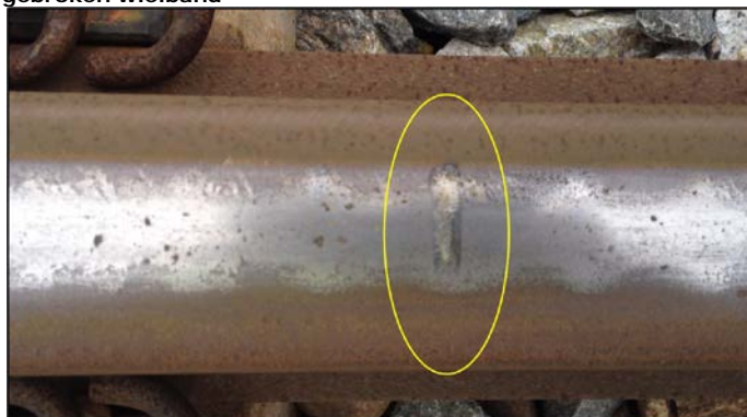
Afbeelding 9 foto van (repeterende) sporen op de kop van de spoorstaaf, die duiden op een gebroken wielband
