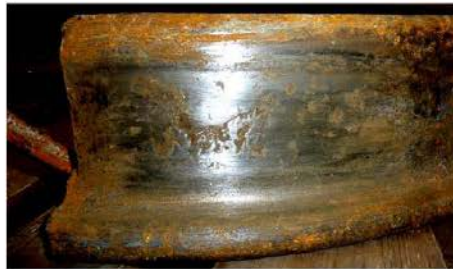
Foto 3: Scheurvorming en uitbrokkelingen t.p.v. breukvlak ('vlaske plaats').
